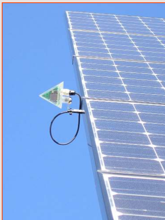
* Detalle de una placa solar fotovoltaica con sensor de seguimiento
